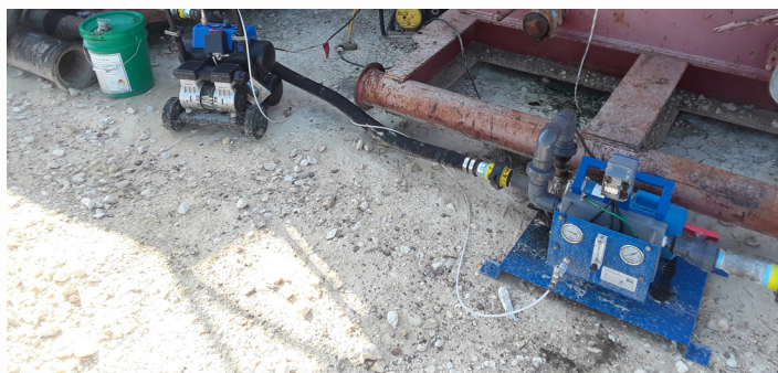
El generador de nanoburbujas 50 XTB trató el agua producida en un tercer tanque.
